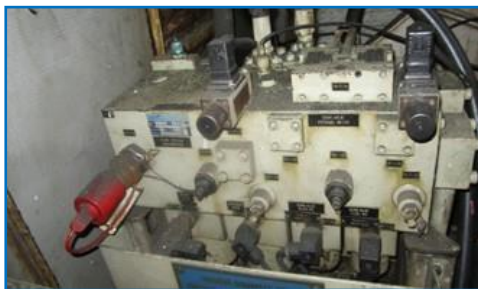
Gambar 3. Kondisi power pack dan solenoid valve
