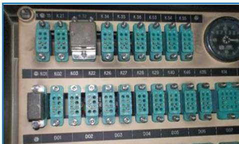
Gambar 4. Kondisi Relai Tidak Lengkap
