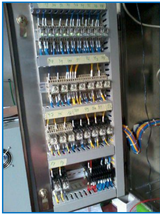
Gambar 17. Bagian Relay pada Master Control
